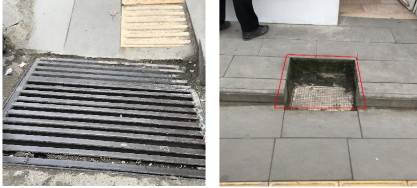
Şekil 6. Izgara ve yağmur oluklarının durumu (Figure 6. Condition of grids and rain gutters)
