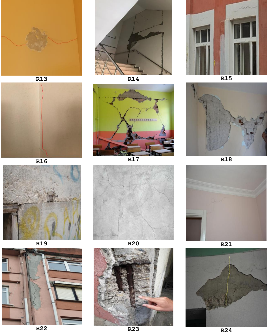
Resim 2. Betonarme Elemanlarda Yapısal Olmayan Hasar Örnekleri [8] (Photo 2. Examples of Non-Structural Damage in Reinforced Concrete Elements)
