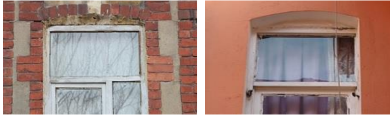
Şekil 12. Kasa ile kemer arasında boşluk bulunan pencereler (Figure 12. Windows with a space between the frame and the arch)
