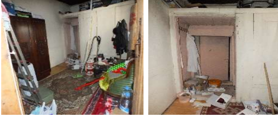
Şekil 20. Z04 mekânı ve sökülen gusülhane (Figure 20. Z04 Room and broken bathroom)
