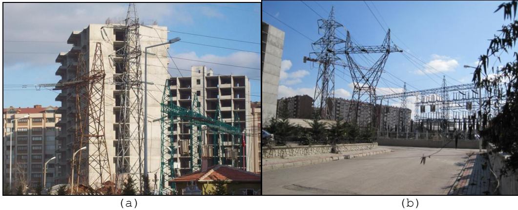
Şekil 2. Yerleşim alanlarına yakın mesafede trafo merkezi [36] (Figure 2. Substation is close to residential areas)
