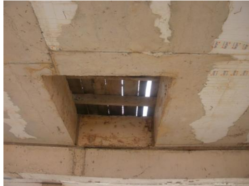
Şekil 3. Döşemedeki boşluklar (Figure 3. Closing floor spaces)
